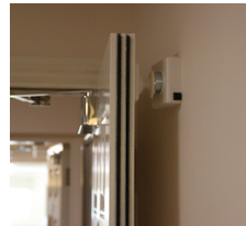
Fire door 'hold-open' device
